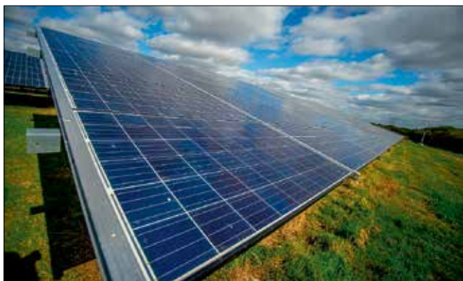
Das Solarkraftwerk mit einer Leistung von 7,4 Megawatt stabilisiert mit einem Hochvoltpeicher das Stromnetz.
