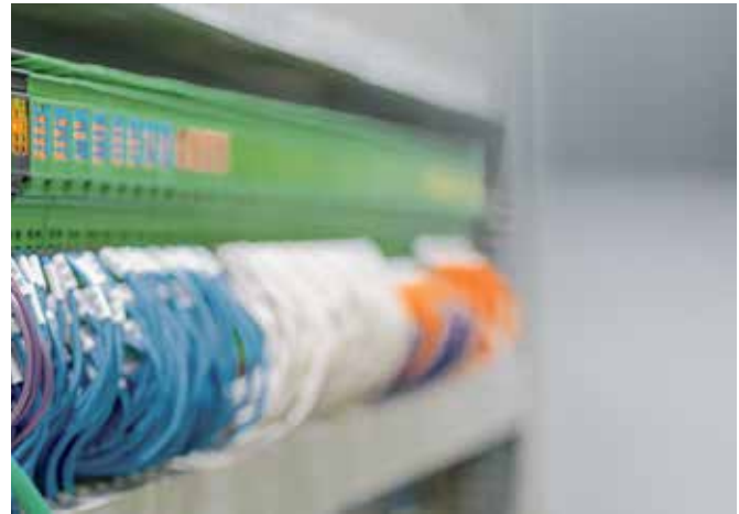
Neben den Wetterdaten normalisiert der ILC 2050 BI die Daten aus den Kältemaschinen, Blockheizkraftwerken und Absorbern.
