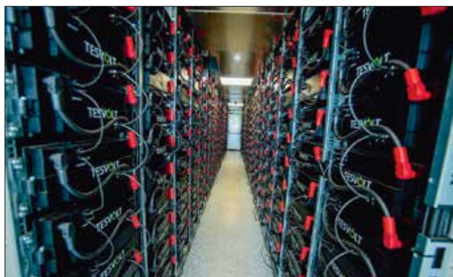
Die Tesvolt-Batterien werden auf Zellebene überwacht.
