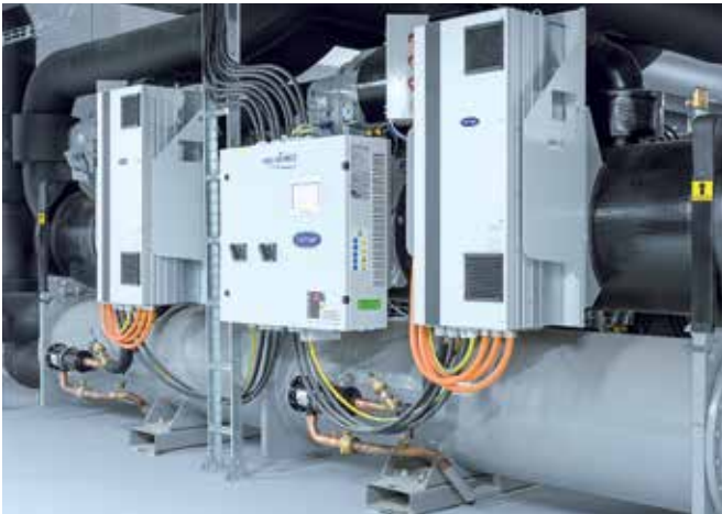
Um den Bedarf an Prozesskälte umzusetzen, sind auf dem Areal in Blomberg zwei Kältezentralen eingerichtet worden.
