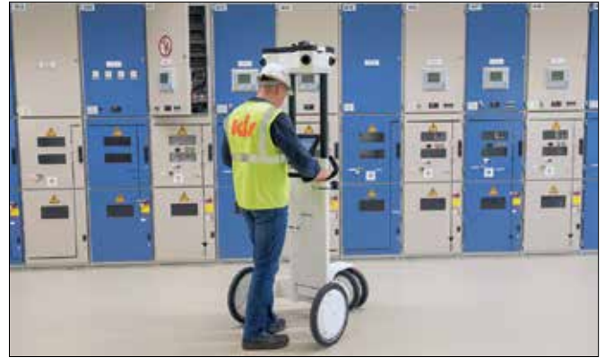
Der Scan-Trolley erfasst die gesamte Anlage.
