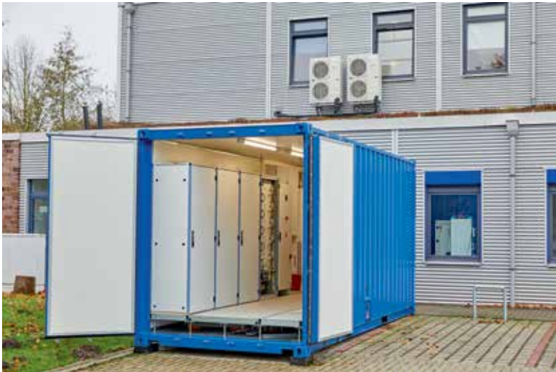
Regenerative Energien für die E-Mobilität: In Spitzenzeiten wird der Ladeprozess mittels Batteriespeicher optimiert.
