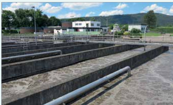
Vier Belebungsstraßen sorgen im Klärwerk Rheinfelden-Herten für die aerobe biologische Abwasserreinigung.
