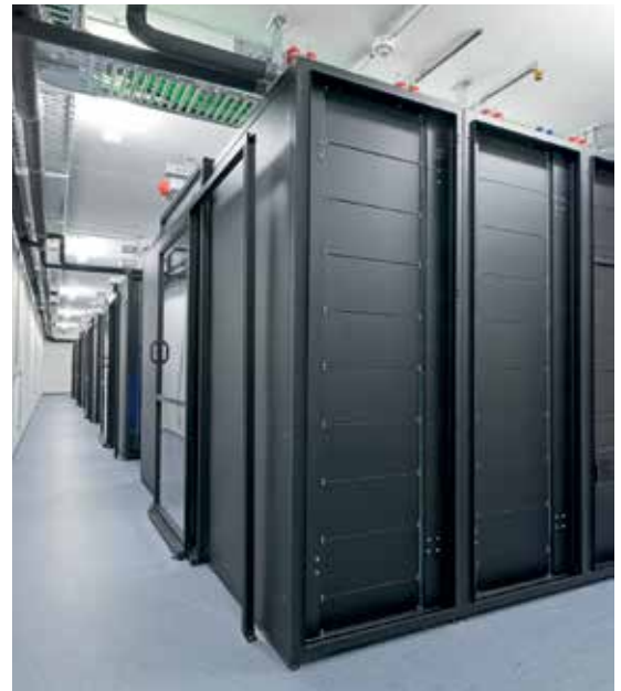
Hier herrscht Sicherheit: Zertifizierte IT-Service-Provider betreiben und verwalten Cloud-Software im sicheren Data Center und übernehmen die Verantwortung für die IT-Infrastruktur.
