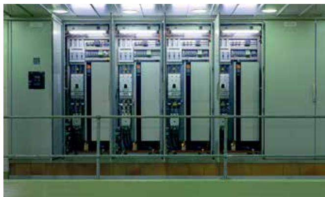
Frequenzumrichter vom Typ VLT Aqua Drive regeln die Drehzahl der Pumpen so, dass die Motoren im optimalen Bereich laufen.
