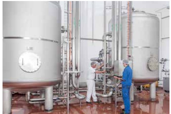
Hygienische Brunnenwasser-Filtration in einer Molkerei: Aufbereitung von 120 m 3 /h Brunnenwasser zu Trinkwasser
