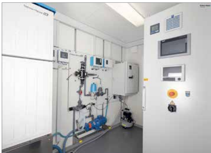
Begehbarer Messcontainer für die Überwachung der Gewässereinleitung
