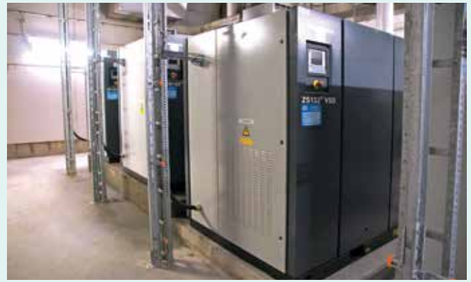
Vier ölfrei verdichtende Schraubengebläse versorgen die aerobe biologische Abwasserreinigungsstufe mit Druckluft.
