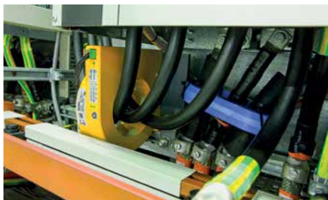
Die Motorkabel sind mit Common-Mode-Filtern ausgestattet, um hochfrequente Einstreuungen bei den Motorkabeln zu verhindern.
