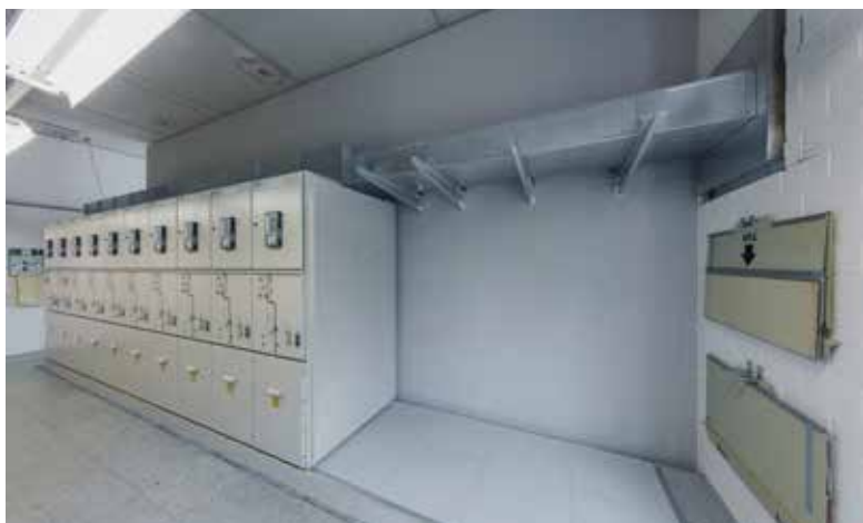
Da Nxplus C gasisoliert ist, verfügt die Schaltanlage über kompakte Abmessungen und hat bei den Stadtwerken Neustadt zusätzlichen Platz geschaffen.
